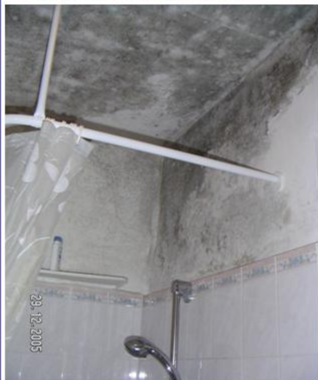
Plafond de salle d'eau ...
